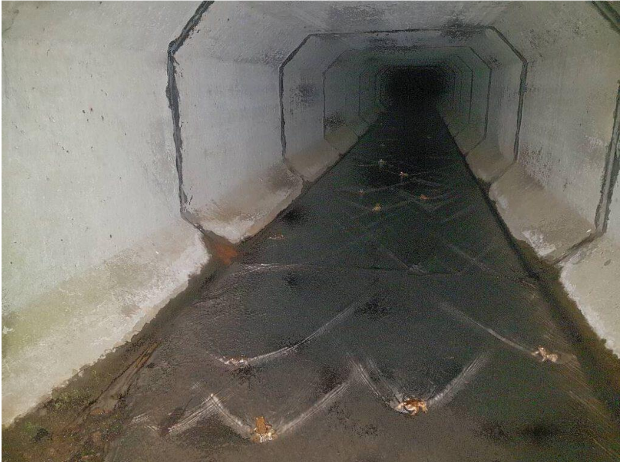
Abbildung 12: Blick in den Durchlass des Süggebaches unter der Brechtener Straße mit zahlreichen Erdkröten (Foto: 25.03.2021).
