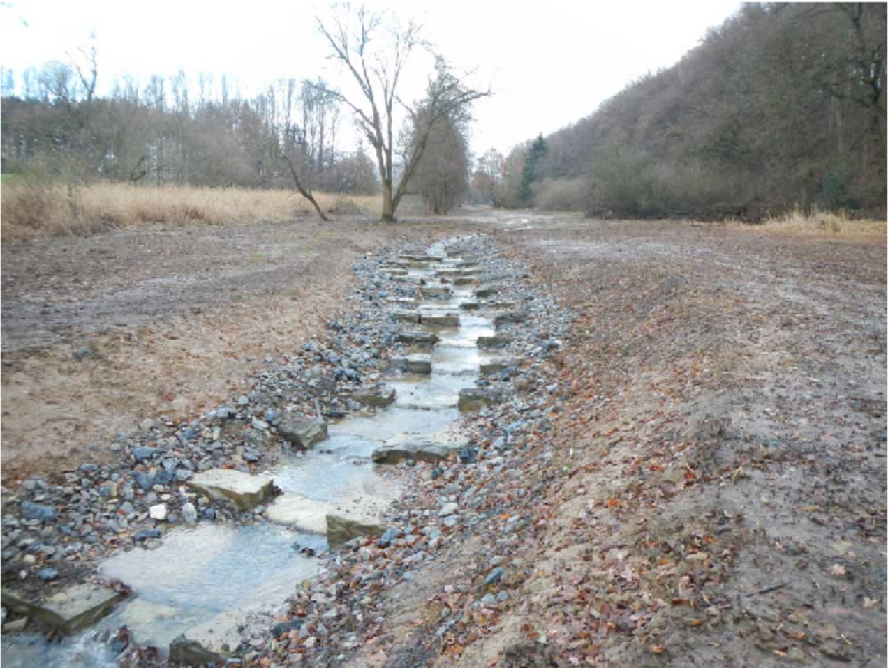
Sohlrampe am Süden des Naturschutzgebietes zum Abbau des Längsgefälles und zum Anschluß an das vorhandene Bachbett
